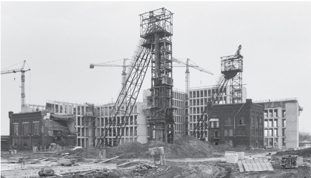
Afb. 13 De sloop van de bovengrondse gebouwen van de mijn Oranje-Nassau I in 1977. De beide kasteelachtige gebouwen bleven gespaard. Het rechter gebouw is nu mijnmuseum. Foto: Beeldbank Rijksdienst voor het Cultureel Erfgoed, Amersfoort, nr. 192021.
