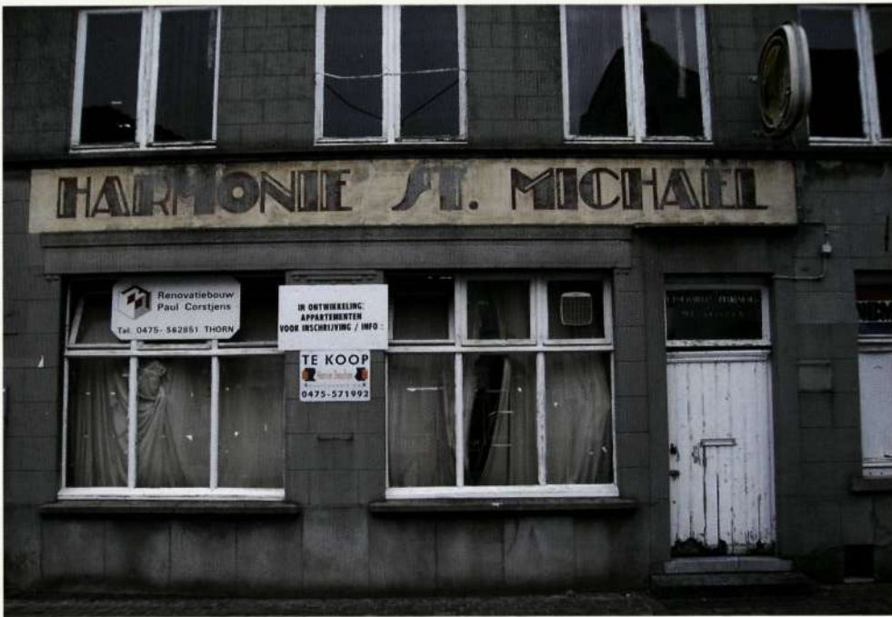
Afb. 3. Pand in verwaarloosde toestand Thorn.
