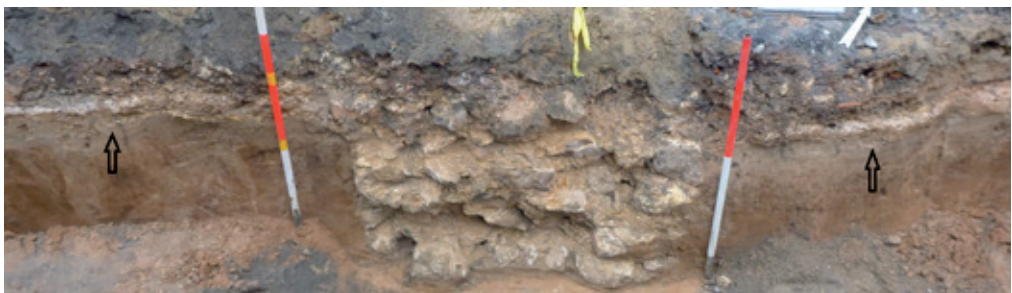
Afb. 29 Stiep S204 in het noordprofiel van put 13, met aan beide zijden resten van een vloer van kalkmortel (zwarte pijlen). Bron: Tichelman, 2020, afb. 61.
