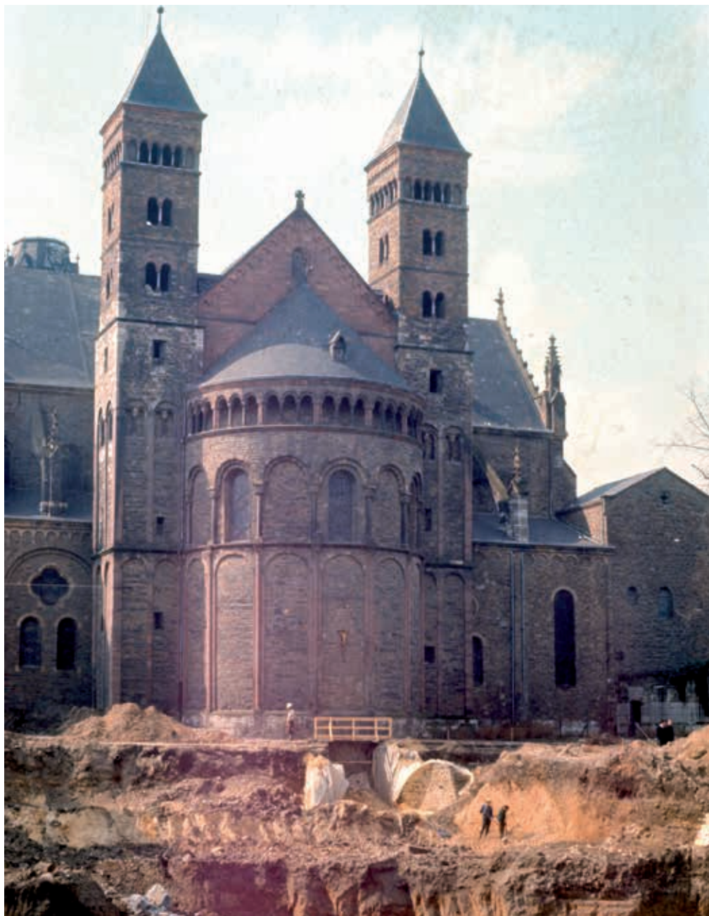
Tijdens de aanleg van de bouwput en van werkput 2 kwam de ontgraving erg dicht bij de Sint Servaaskerk. De enorme steunberen die de Romaanse absis ondersteunen en die moeten voorkomen dat de kerk van de terrasrand afschuift, zijn zichtbaar onder de witte plastic zeilen. Foto ROB 1969-1970, afkomstig uit opgravingsdocumentatie Vrijthofonderzoek 1969-1970, in beheer bij Gemeente Maastricht/Centre Céramique.
